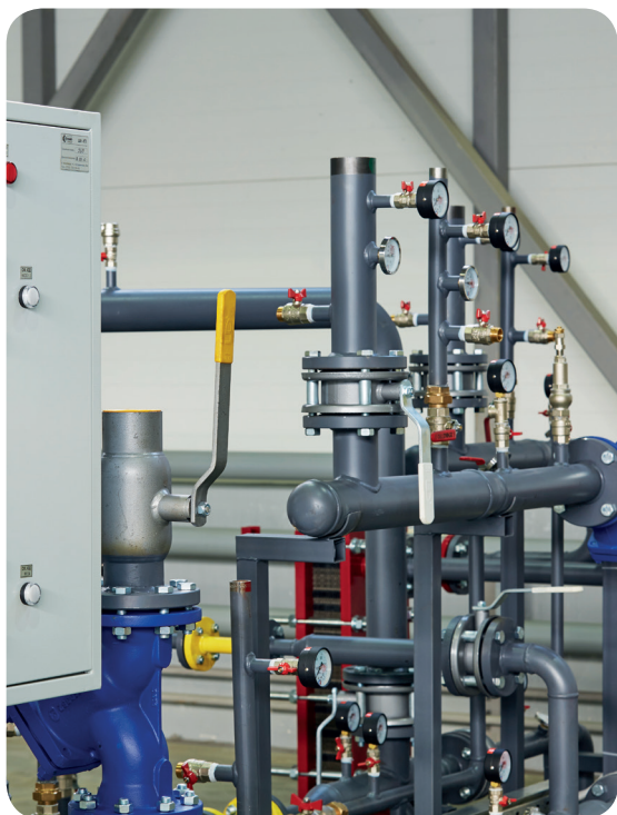
ИНДИВИДУАЛЬНЫЙ ТЕПЛОВОЙ ПУНКТ
